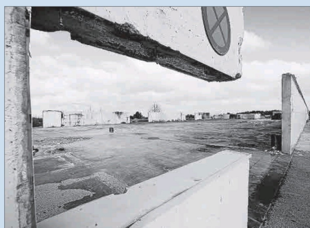
Se ha mantenido parte de la estructura que no fue afectada por las llamas.
