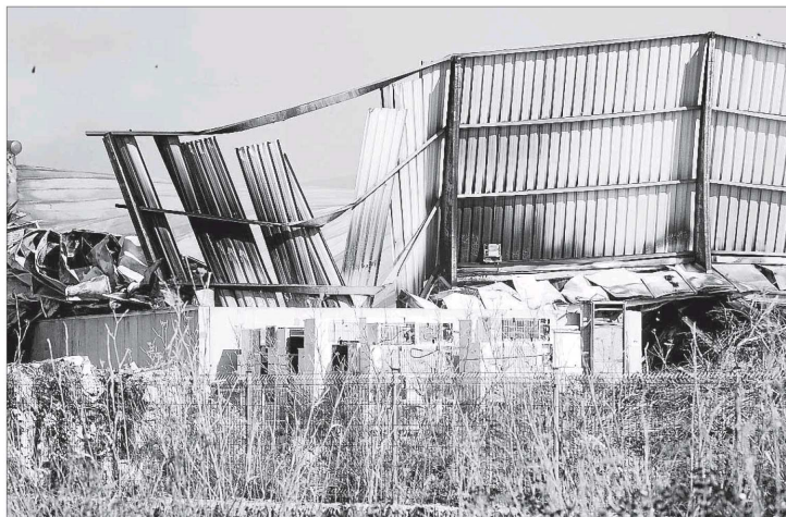
Imagen externa de la entrada frontal de la nave, ayer por la mañana. © FOTO JAVIER COLL
